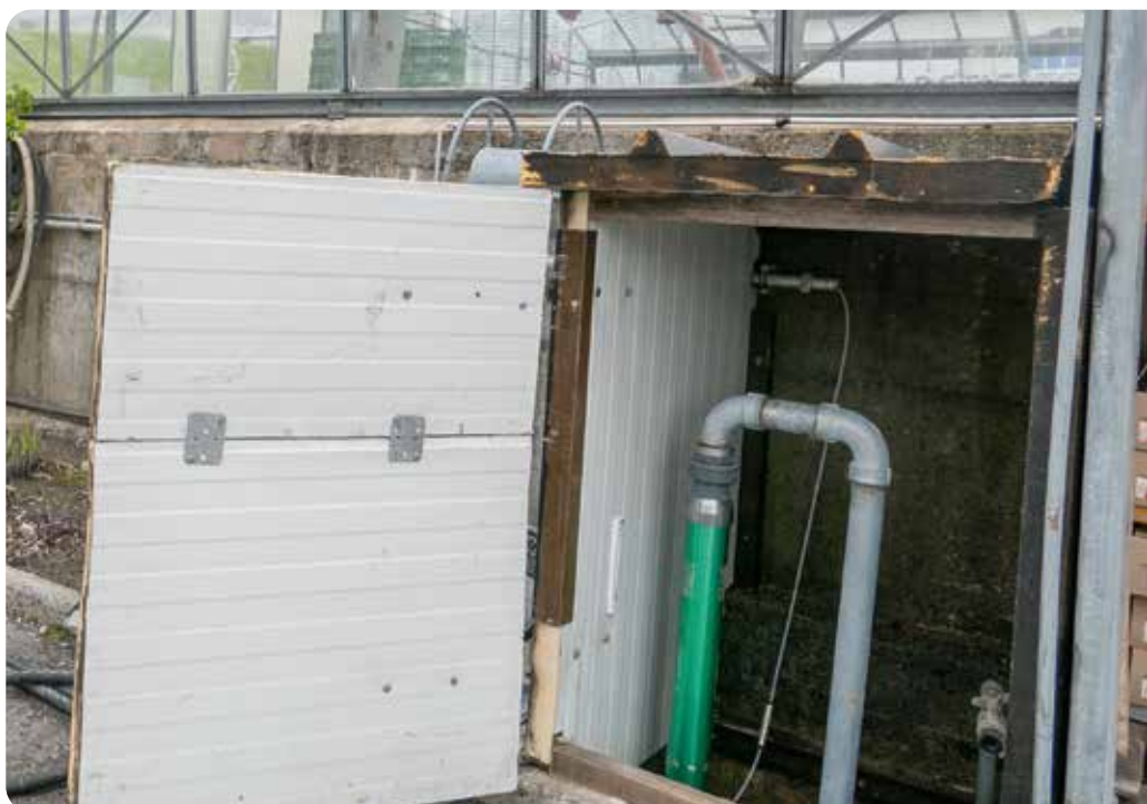
Sur l'exploitation maraîchère à Udligenswil, une unité est installée au raccordement de l'eau du robinet.
